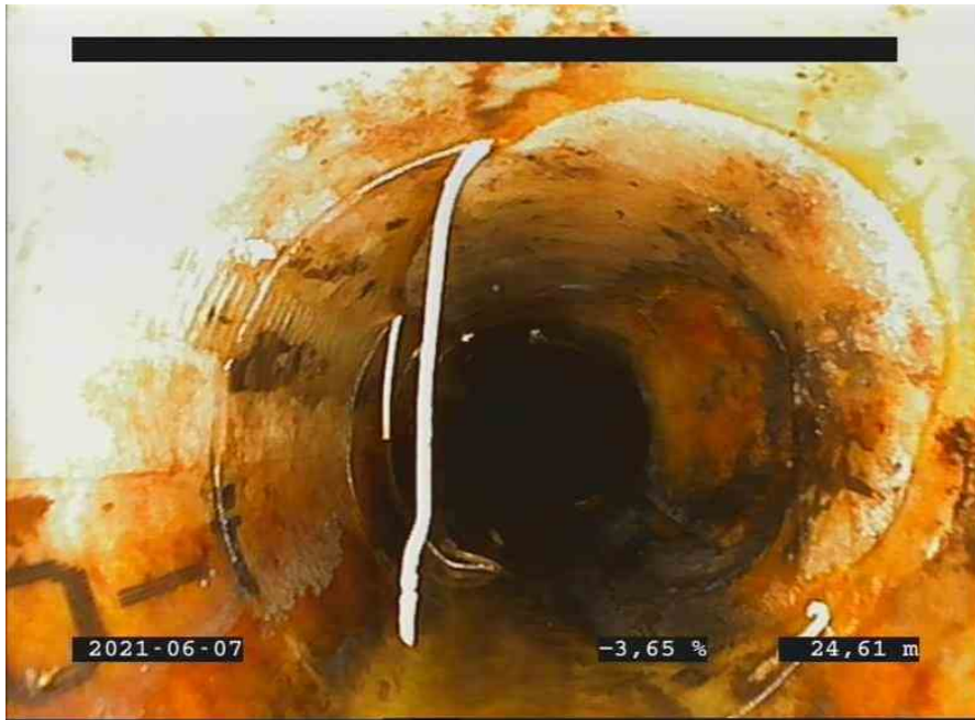
Brunn 5Brunn 707062113593A.jpg, 00:04:26, 24.61m Produktionsfel 1. Felet medför en reduktion av tvärsnittsarean mindre än 5 %, Cirkulär
