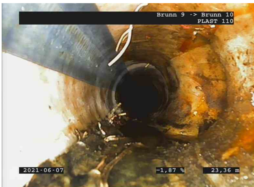
Brunn 9Brunn 1007062115094A.jpg, 00:04:02, 23.36m Produktionsfel 2. Felet medför en reduktion av tvärsnittsarean på mellan 5-15 %, Cirkulär från 5 till 7
